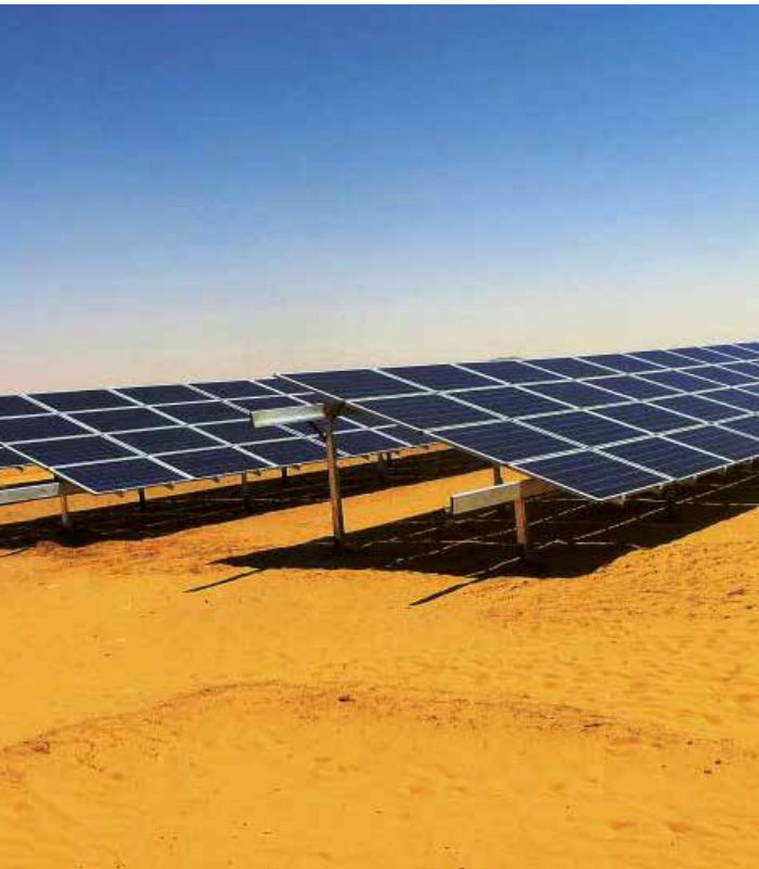
Wüsteninstallationen (bis zu 50 °C)
